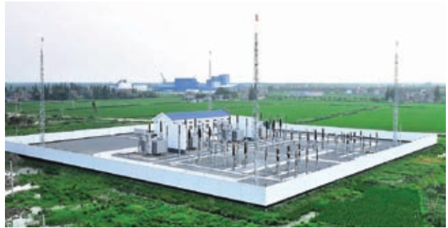
沪杭铁路松江南变电所采用环保技术和材料
